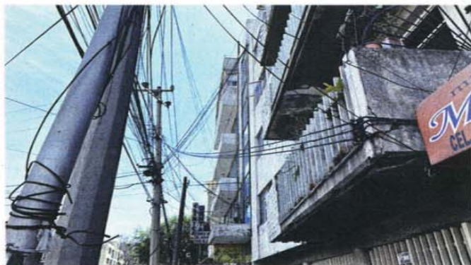
Las marañas de cables, ya sea de telefonía o de internet, cuelgan de los postes de las colonias.
