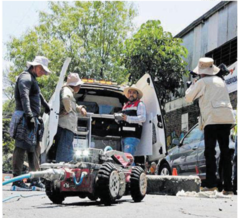
Personal de Sacmex utiliza un robot con cámara para ver condiciones del drenaje.
