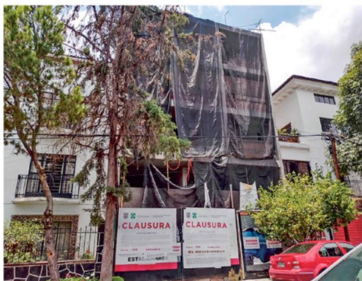
DESCARTES 100, ANZURES. Enormes carteles de clausurado impiden que continúen las obras de este edificio, que excede en altura a los inmuebles cercanos.
