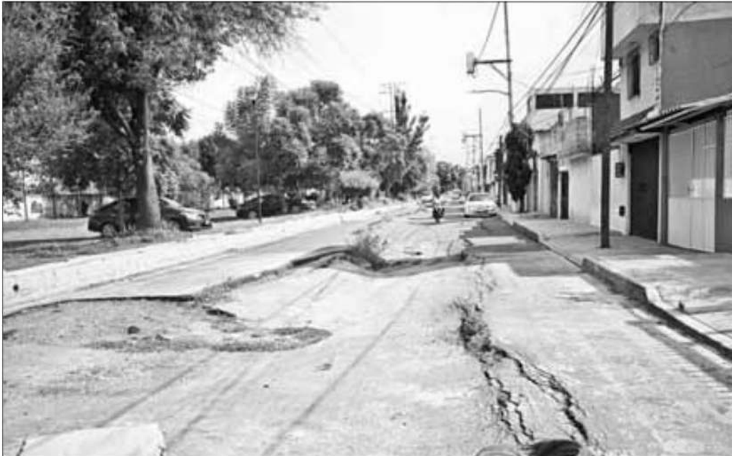
▲ Socavón en la calle 321 de la colonia El Coyoil, donde desde enero pasado el alcalde Francisco Chígüil se comprometió a resolver el problema que afecta tres cuadras, señalaron vecinos. Foto Yazmín Ortega Cortés
