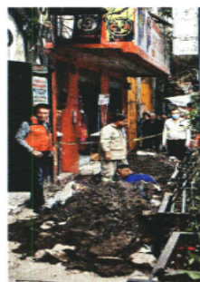
Fugas de agua fueron atendidas en esa misma zona tras los microsismos.
