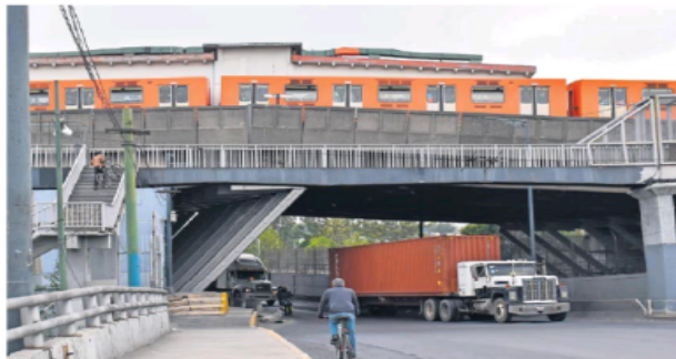
En la zona de Pantitlán se han detectado asentamientos diferenciales de 80 centímetros, lo que ha derivado en una disminución en la velocidad de los trenes.
