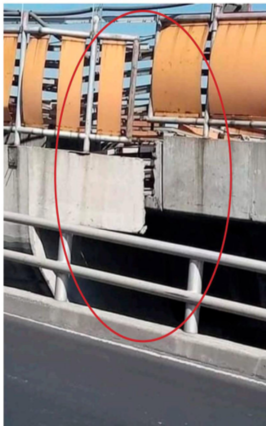
Internautas manifestaron su preocupación por posibles cuarteaduras y separaciones en varios pilares y rieles.
