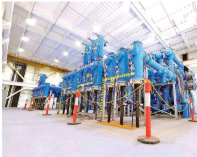
La nueva subestación eléctrica de alta tensión abarca una superficie de 380 metros cuadrados y funciona como nodo receptor de la energía proveniente de la Red Nacional de Transmisión, bajo el ordenamiento de la CFE /CORTESÍA: STC METRO
