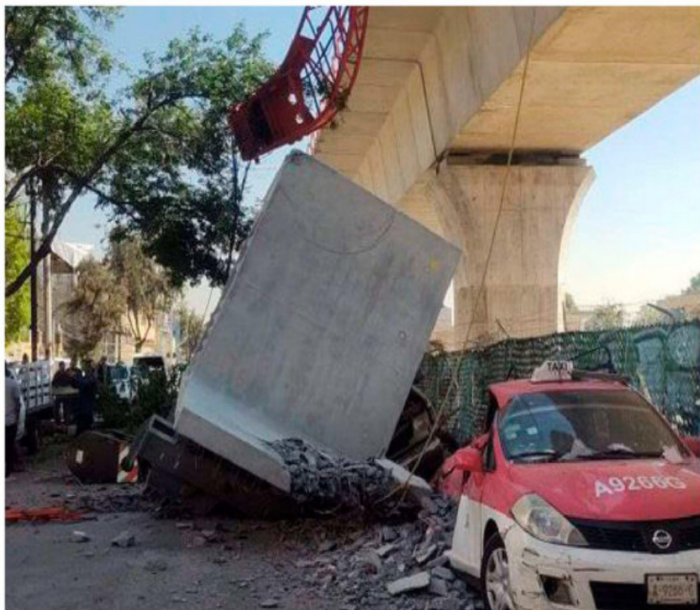
Dos vehículos fueron aplastados por el concreto.
