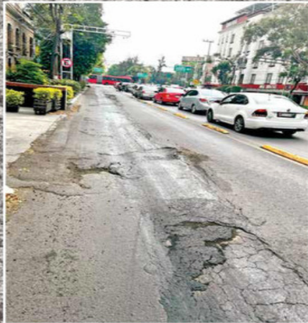
Los carriles confinados presentan desniveles, por lo que desde 2023 la Sobse comenzó a atender la problemática.
