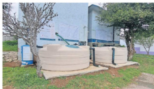
Por el momento 72 escuelas de Milpa Alta cuentan con equipos para captar agua pluvial, lo que beneficiará a 40 mil personas, informaron.
