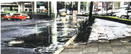
■ Para evitar el desperdicio sobre Periférico, casi esquina con Campos Eliseos, la válvula fue cerrada.
