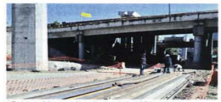
■ En las revisiones más recientes de la ASF, las obras del Tren Interurbano han presentado diversas anomalías.
