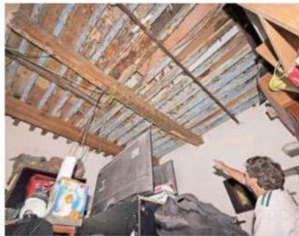
Se les cayó el techo en una de las viviendas, mientras que en la otra está a punto de colapsar
