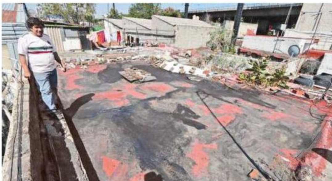
Están en riesgo 16 viviendas, razón por lo que ya fueron desalojadas algunas familias
