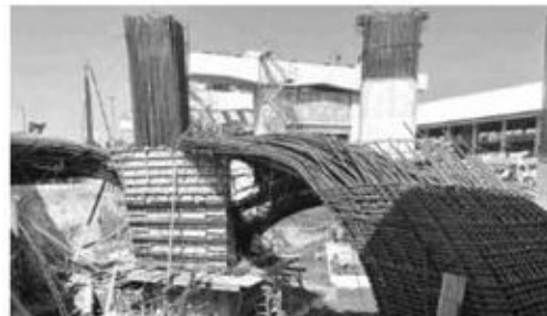
Desplome en el CETRAM Santa Martha Acatitla
