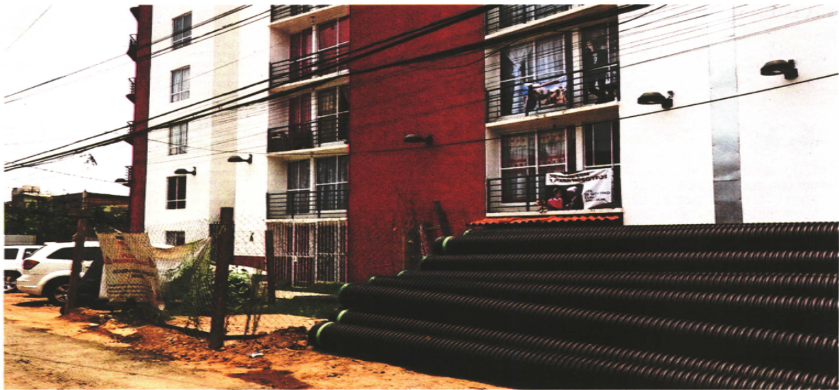
En Miguel Hidalgo, autoridades capitalinas construyeron la Ciudad del Bienestar al lado de una mina. A decir del alcalde, para la población esta construcción es insegura.
