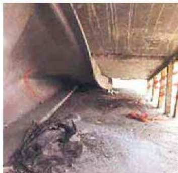
DETALLES. Algunas de las fallas en la construcción, reveladas en el dictamen.
