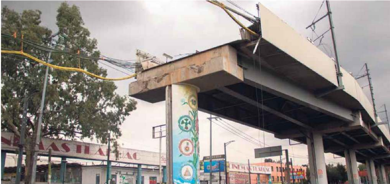
DESPLOME. Sección de la parte elevada de la Línea 12 del Metro, después de la caída de las vías, el 3 de mayo.
