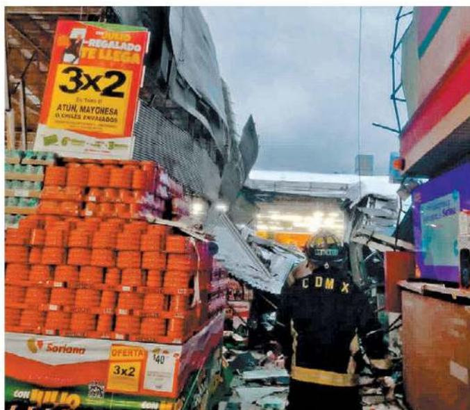
Pese al derrumbe, no se reportaron lesionados. ESPECIAL
