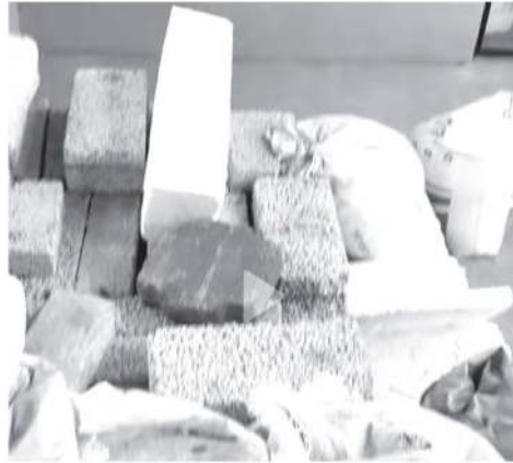
· Aún hay restos de escombros
