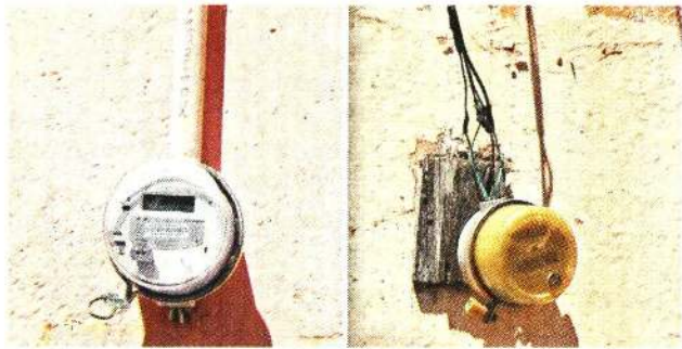
El medidor de doña Bertha está en ceros, mientras que el de un vecino en Villahermosa (der.) fue alterado.
