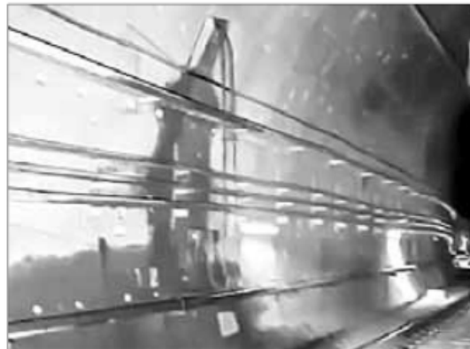
▲ Trabajos de perforación para erigir un inmueble de manera irregular en Benito Juárez atravesaron el túnel de la línea 12 del Metro entre las estaciones Eje Central y Parque de los Venados, lo que causó filtraciones de agua, lodo y material de construcción. Foto La Jornada
