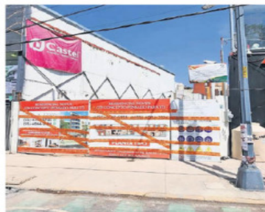
La excavación que dañó el túnel de la L12 enfrentó al Gobierno capitalino y a la alcaldía Benito Juárez.
