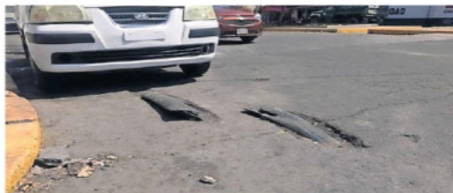
En las calles hay tubos de polietileno sueltos, que sobresalen de la carpeta asfáltica y no están debidamente conectados a la red hidráulica.
