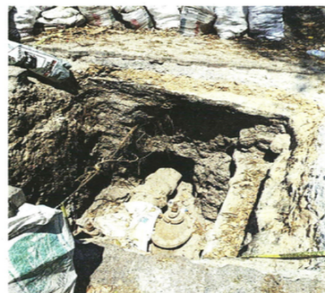
■ La tubería quedó al descubierto tras una reparación, sin embargo, los responsables “olvidaron” tapar la oquedad.
