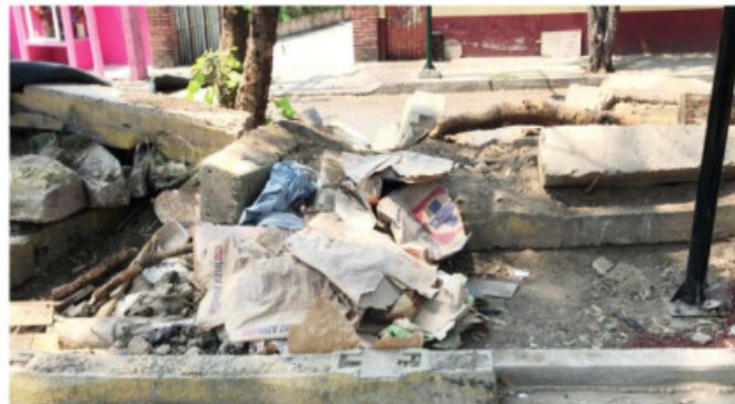
· Debido a los trabajos inconclusos, así lucen una vialidad en Azcapotzalco
