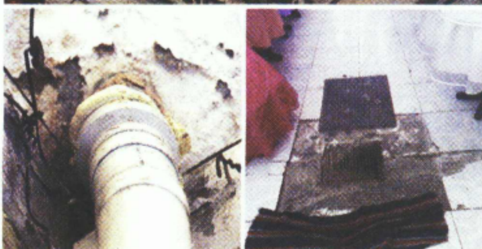
El techo tiene huecos por donde entra el agua de lluvia; las filtraciones de las tuberías son evidentes y las coladeras presentan desgaste.
