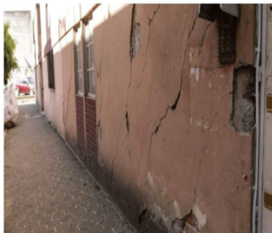
Edificio Patanco dañado estructuralmente por sismos.
