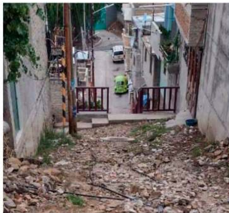
Calles carecen del pavimento en las empinadas calles de Sierra de Guadalupe.
