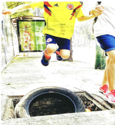
■ Sobre Mariano Escobedo, en la Colonia Granada, una llanta advierte a los peatones de la falta de tapa en un registro.
