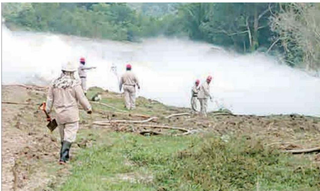
▲ Personal de Petróleos Mexicanos y de protección civil del municipio de Agua Dulce, Veracruz, realizan labores para controlar una fuga de gas etano en un ducto ubicado a un costado de la carretera Costera del Golfo, en el tramo Coatzacoalcos-Villahermosa. Foto La Jornada
