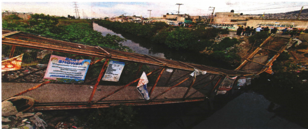
Parte de la estructura metálica cayó al río de La Compañía. Vecinos indicaron que el puente tenía las mallas rotas.
