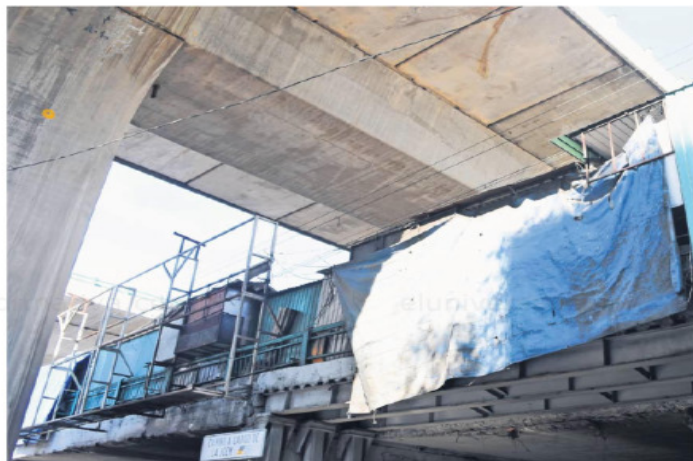
El puente vehicular que se ubica en el límite entre la Ciudad y el Estado de México registra una sobrecarga por la cantidad de puestos ambulantes y anuncios espectaculares.
