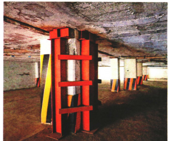
Los damnificados se oponen a la rehabilitación, pues aseguran que este edificio ya presenta un grave daño estructural y es un peligro latente.
