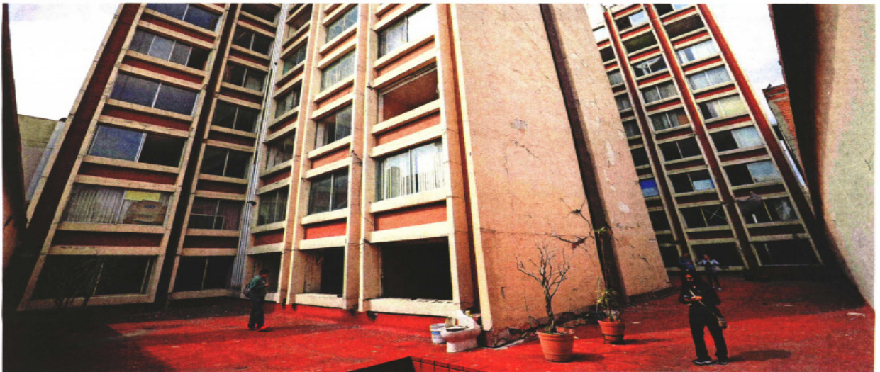
El predio se compone por dos torres con 70 departamentos. EL UNIVERSAL pudo constatar las grandes grietas y el daño estructural.
