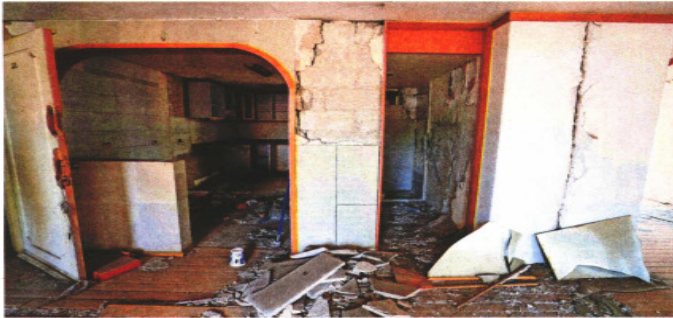
En el lugar se siguen viendo los estragos que dejó el sismo de 2017: vidrios rotos, puertas y baños desechos, acabados en el suelo.
