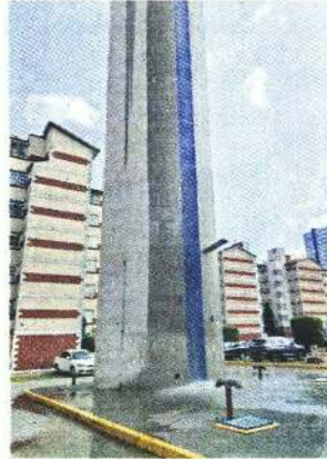
■ Vecinos de la Colonia Carola buscan que se reparen las cisternas de una unidad habitacional.
