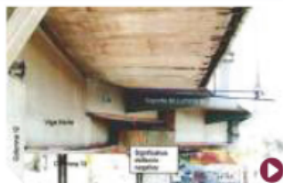
Captura de un video en el 2019 que muestra deflexión negativa de las vigas norte y T-6.
