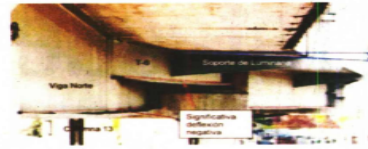
Imagen que muestra una importante deflexión negativa en la viga norte y T-6 entre las columnas 12 y 13.
