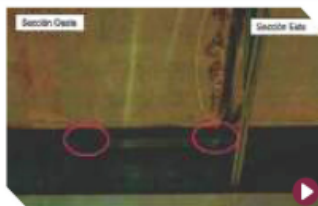
En 2017 se muestra progresión en una mancha de humedad y deformación del refuerzo longitudinal.
