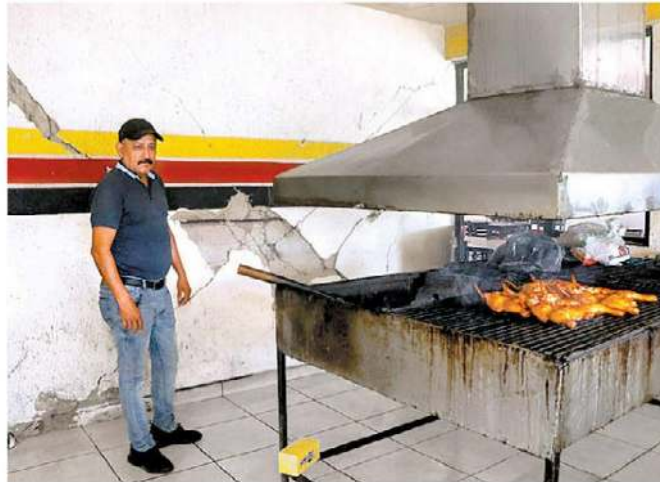
Grietas en el local de Rigoberto Vega. ESPECIAL
