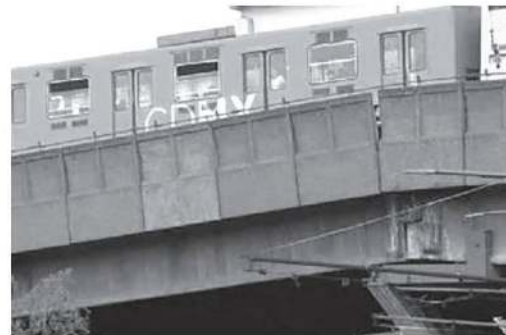
· El tramo elevado presenta daños
