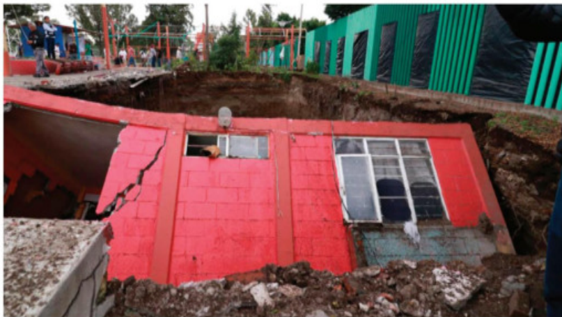
El 29 de julio se formó un socavón de 12 metros de largo, 6 metros de ancho y 10 metros de profundidad en el Deportivo Gertrudis Sánchez de la GAM.
